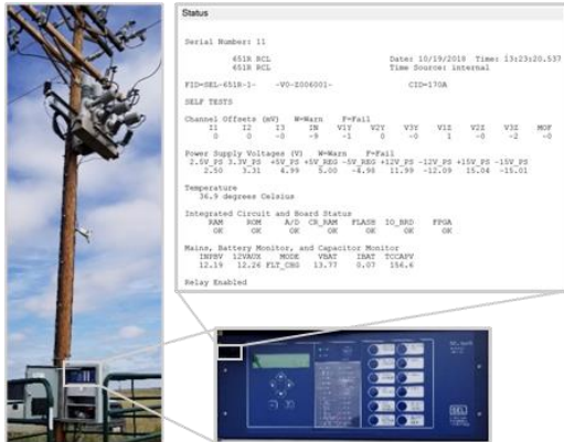
Figura 89. Reconectores, disyuntores de alta tensión, seccionadores y relés
