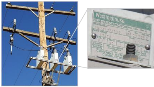
Figura 7. Placas del banco de condensadores de alta tensión
