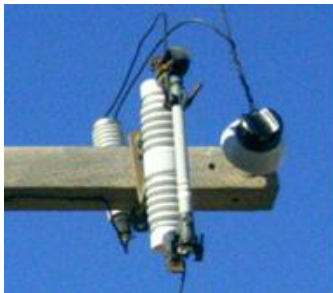
Figura 10. Fusibles de línea y de transformador
