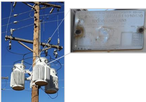
Figura 1112. Placas de transformadores de distribución y de potencia
