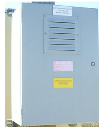
Figura 16. Condensadores de baja tensión
