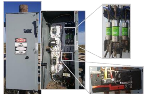
Figura 1415. Paneles de desconexión principal y del motor
